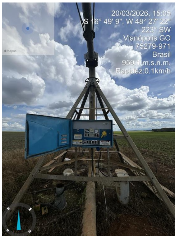
Figura 49 – Imagem do painel de controle do pivo de irrigação.
